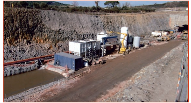
■ [Figura 11].- Planta depuradora para 510 m³/hora.
