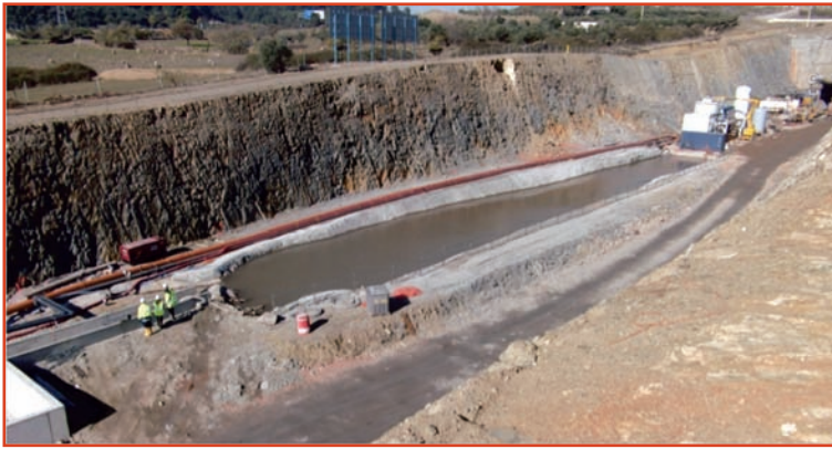
■ [Figura 10].- Balsa de decantación.
