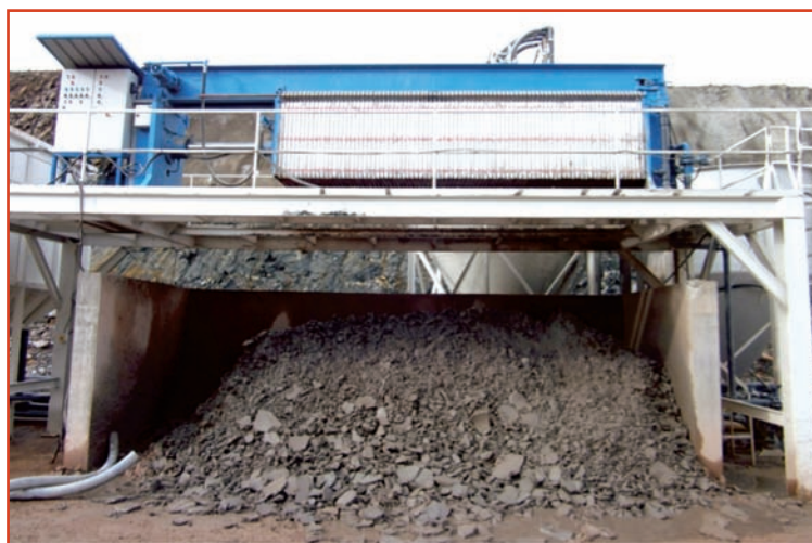
[Figura 8] .- Filtro prensa de la planta de tratamiento.
